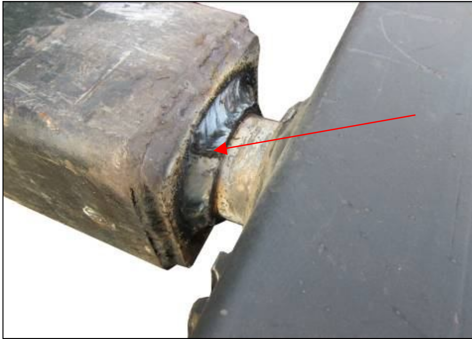
Рисунок А.1 – Сварка по месту разрыва тяги крепления балки катка
