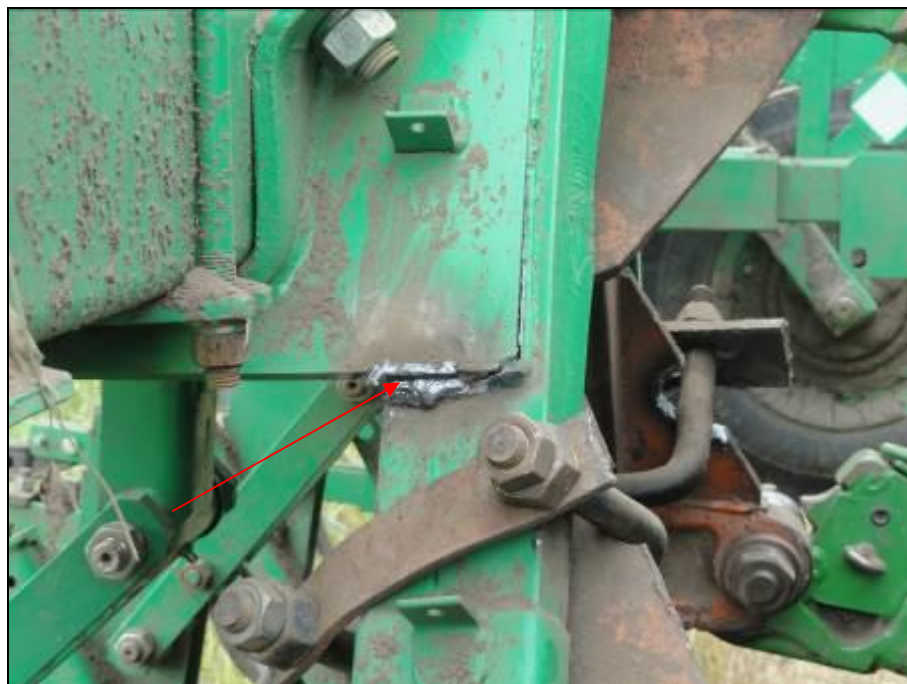
Рисунок А.1 – Трещина по сварному соединению БСУ
