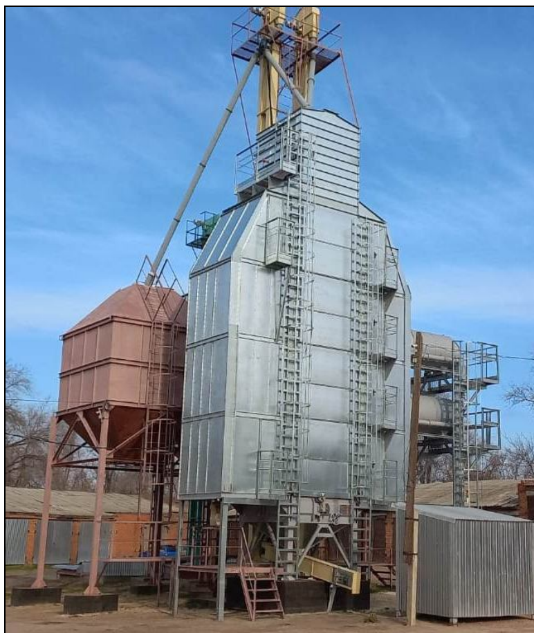
Рисунок 2 – Зерносушилка модульная жалюзийная FLATUM 4-8, в работе (на сушке зерна подсолнечника)
