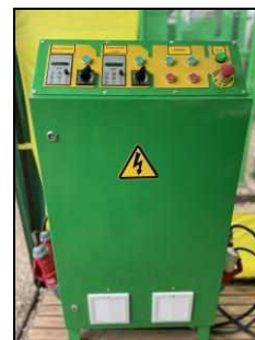
Шкаф управления ОЗФ-80
